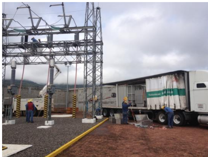
Figura 35.- Ejemplo de prueba con equipo resonante en un sistema de cable de 115 kV ubicado en una subestación.
