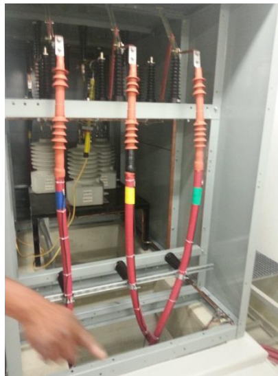
Figura 65.- Acometida de media tensión en un tablero de potencia
