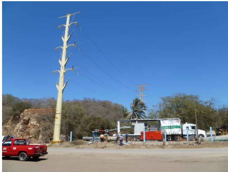
Figura 34.- Ejemplo de prueba con equipo resonante en un sistema de cable de 115 kV ubicado en un poste troncocónico.
