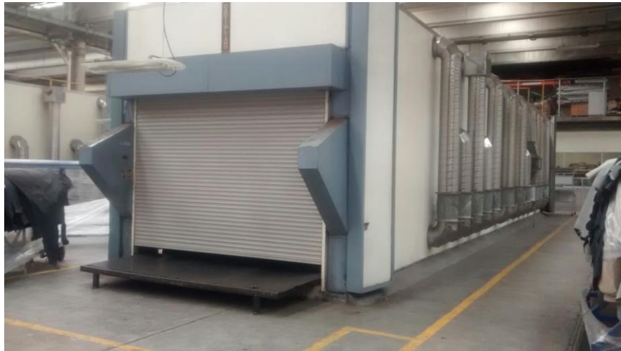
Figura 12.- Cámara de secado LTD
