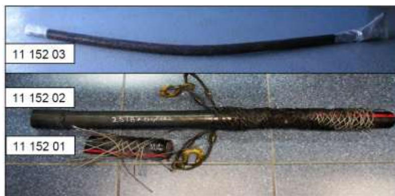
Fig. 3.8 Cable dañado por descargas parciales.
