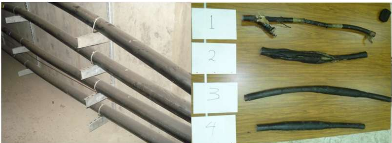
Fig. 1.1. Cables subterráneos antes y después de sufrir una falla.
