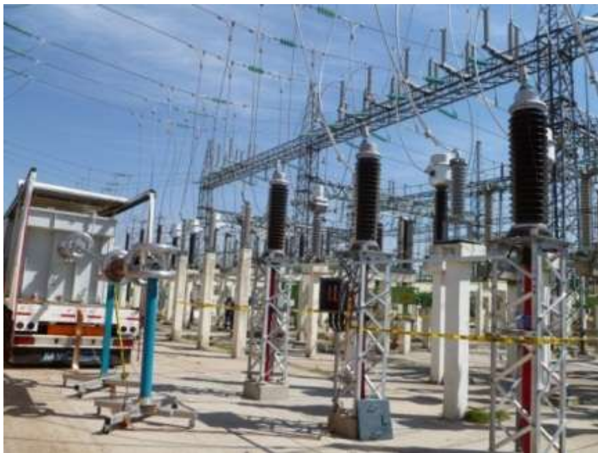
Fig. 3.7 Imagen de la subestación con el tráiler de medición.
