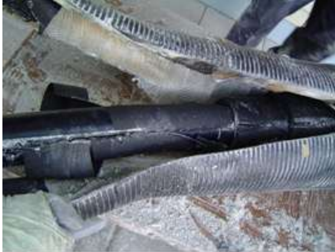
Fig. 3.5 Falla del aislamiento en un empalme.
